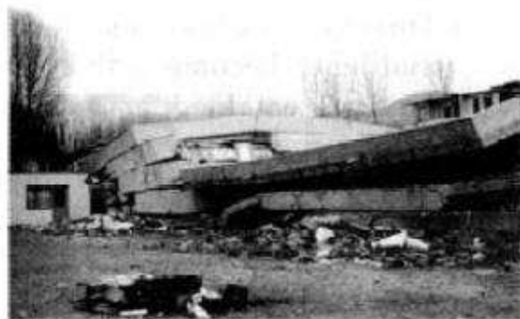
Earthquake - Động đất
